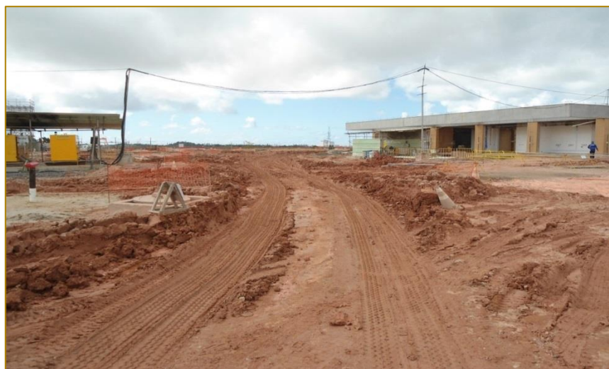
Figura 15 – Acesso com tráfego interrompido. (Antes da manutenção corretiva)
