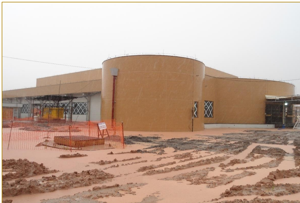
Figura 4 – Alagamento em decorrência da falta de drenagem pluvial.
